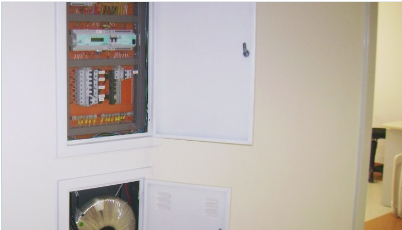
9. Tablero eléctrico de un área quirúrgica: sistema de distribución y protección que contribuye a la continuidad y seguridad del suministro eléctrico hospitalario.
