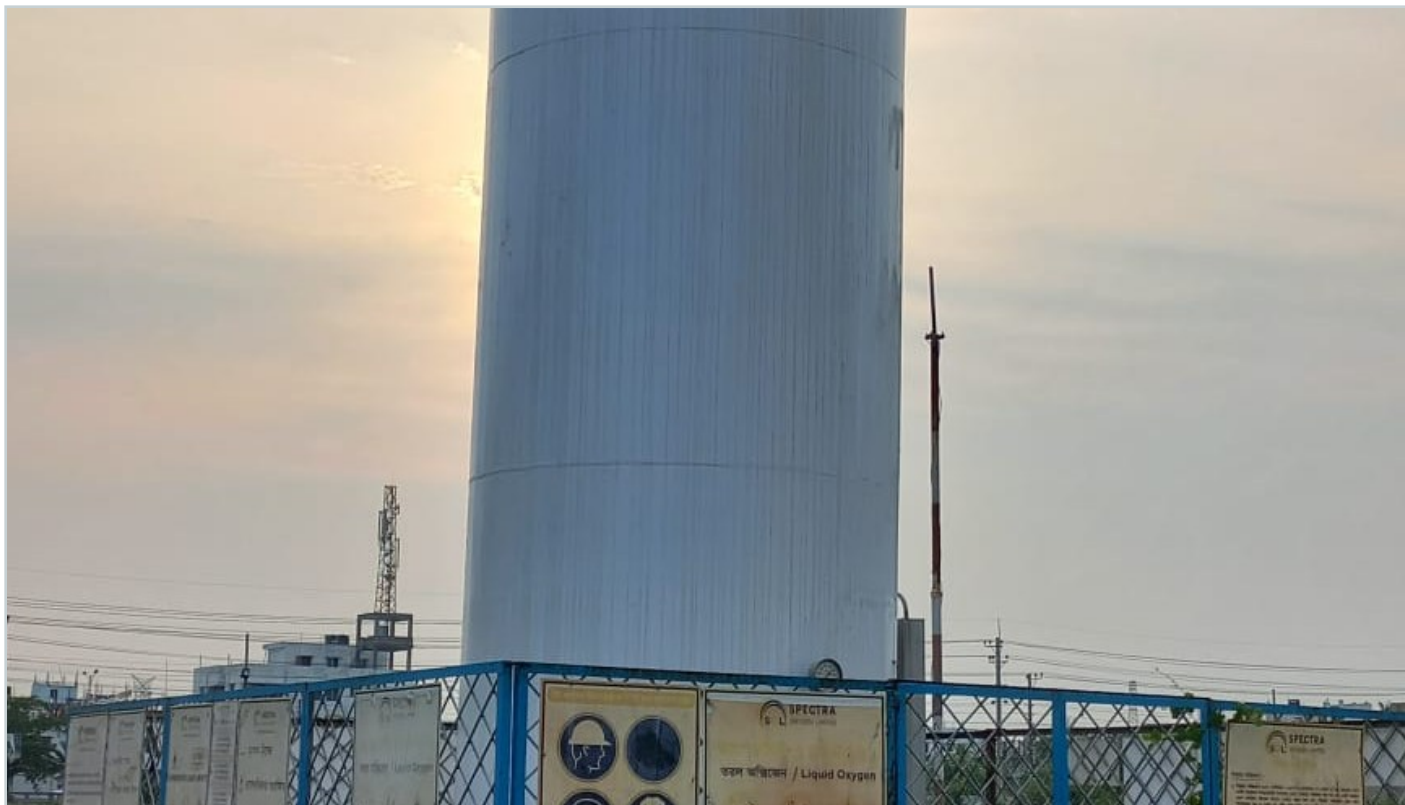
5. Planta de oxígeno medicinal: instalación estratégica para almacenar y abastecer gases esenciales a distintos sectores de un establecimiento de salud.
