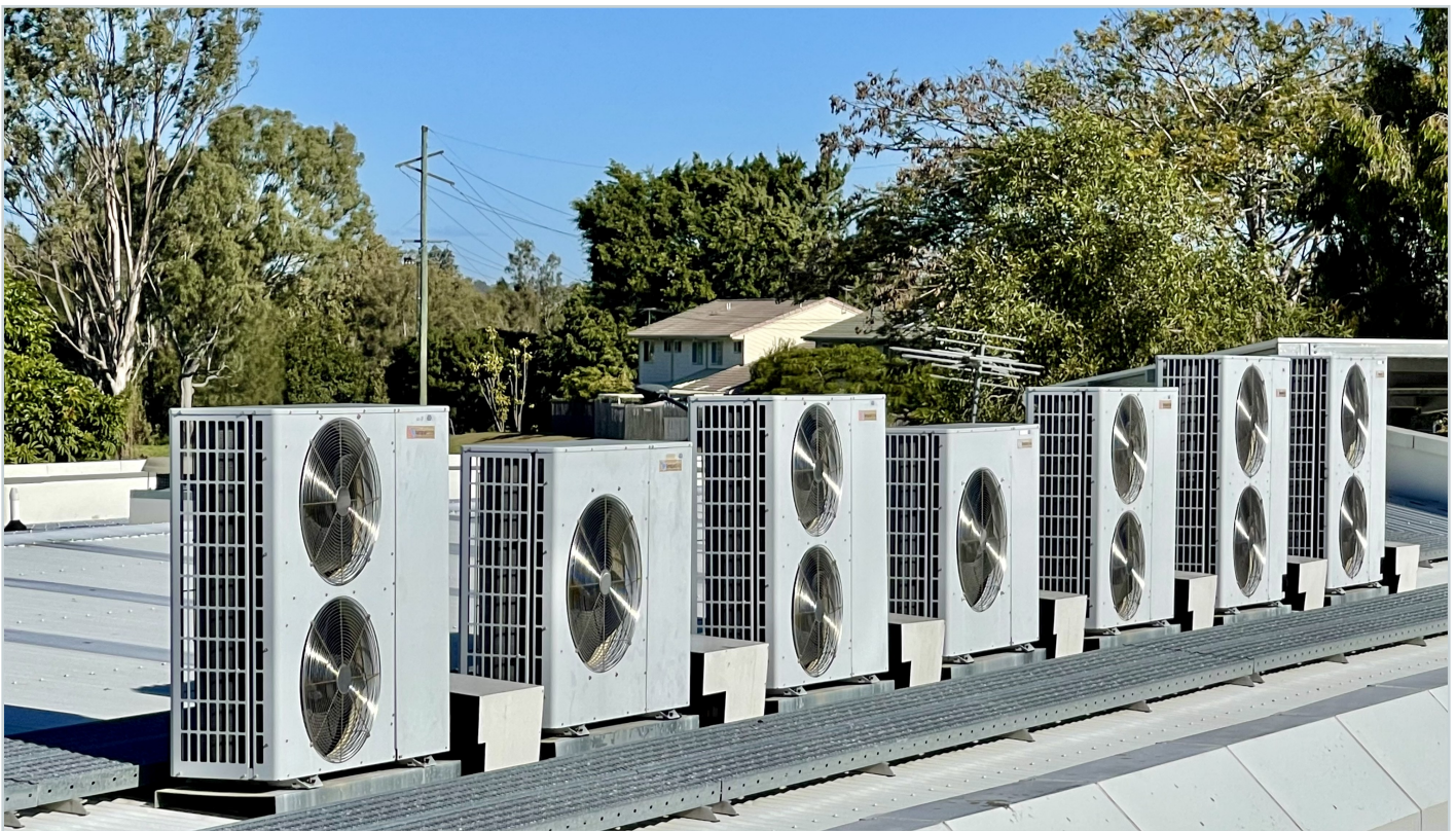
8. Sistemas de climatización hospitalaria: unidades exteriores que forman parte del control térmico y de la calidad del aire en edificios destinados a la atención de pacientes.
