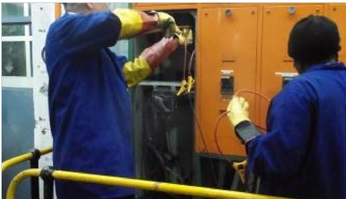
10. Auditoría energética de instalaciones: técnicos realizando mediciones para analizar consumos, detectar pérdidas y proponer mejoras de eficiencia en sistemas eléctricos.
