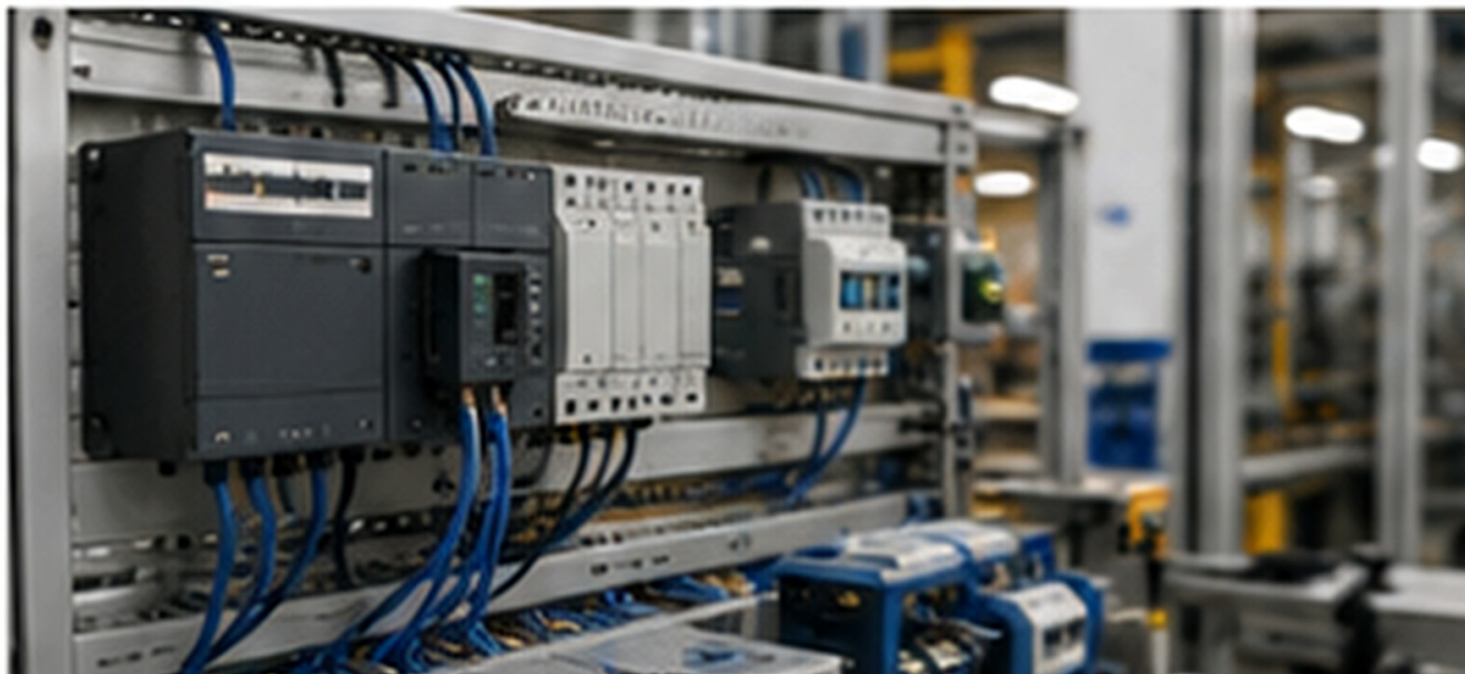
FOTO 1 PLC instalado en un tablero industrial: identificación de módulos, alimentación, entradas y salidas utilizadas para automatizar procesos.
