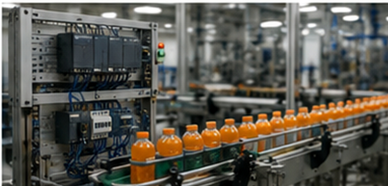
FOTO 3 Automatización de una línea de producción mediante PLC, sensores eléctricos y dispositivos de mando para coordinar el proceso.
