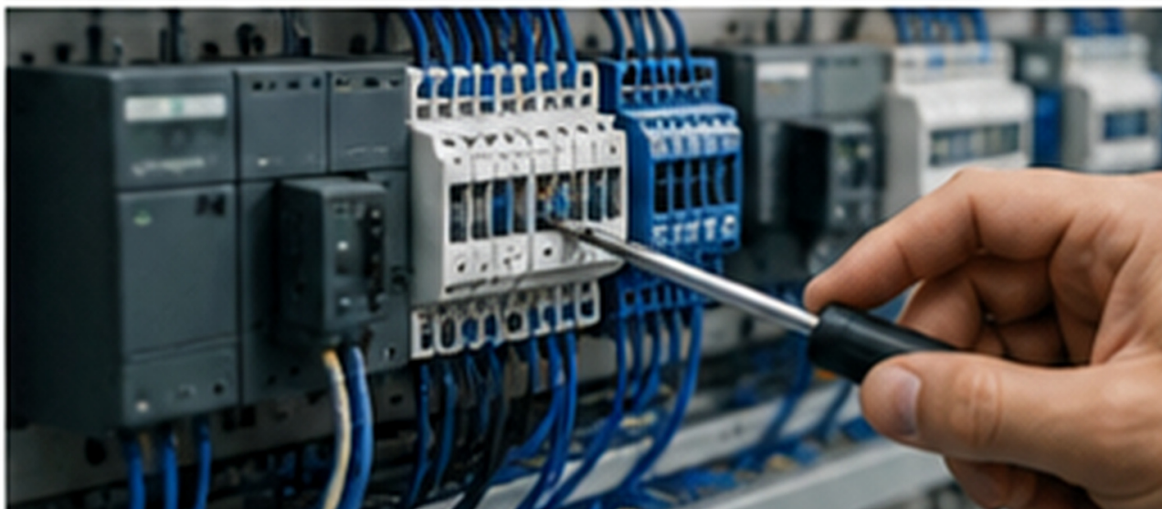
FOTO 7 Revisión de conexiones, relevadores, fusibles y conductores dentro de un tablero eléctrico asociado a un sistema PLC.
